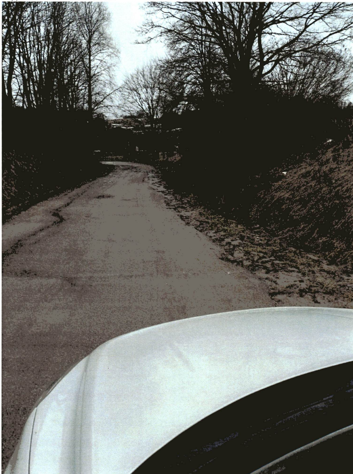
Zdjęcie nr 3 – woda na drodze
